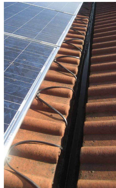
Využití topných kabelů při ochraně žlabů
